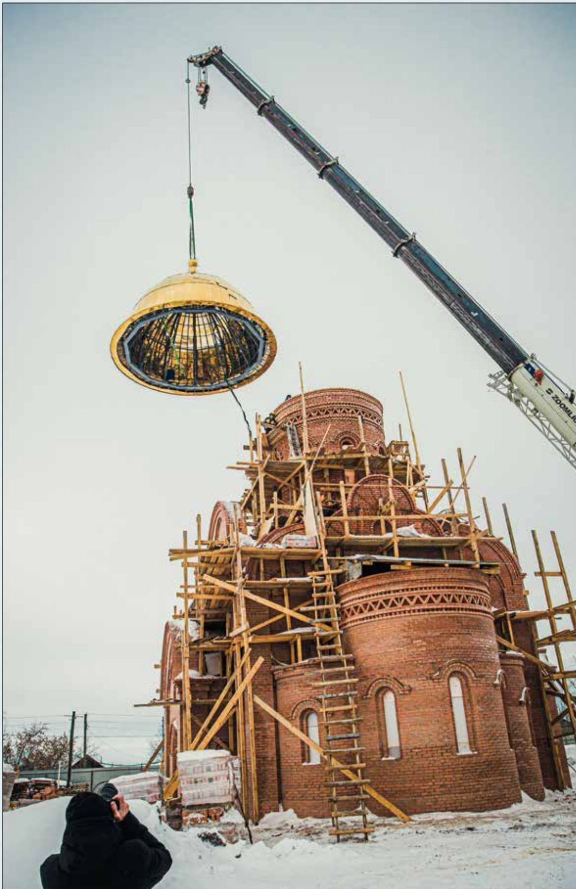
Подъём купола с крестом на восстанавливаемый храм Рождества Христова в селе Прокуткино Ишимского района. 28 декабря 2023 года. Фото автора.
