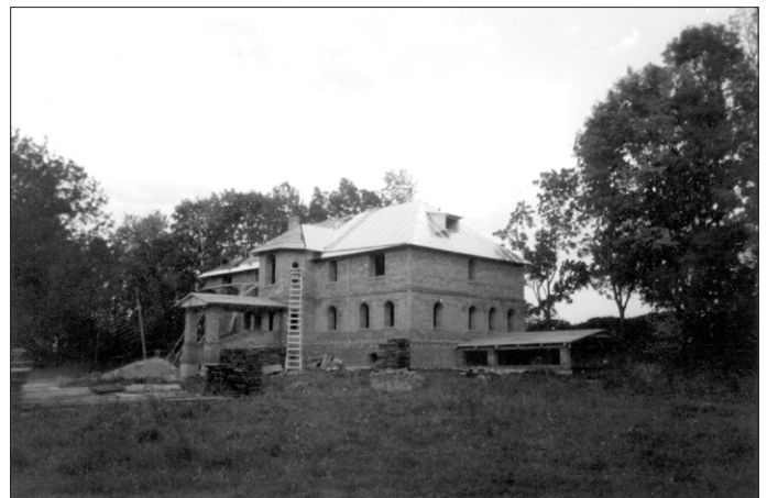
Гдов. Строящееся здание церковно-приходского дома и школы в крепости, сооруженное на пожертвования дочерей о. Иоанна Лёгкого Галины и Ираиды Лёгких. 2001 г.
